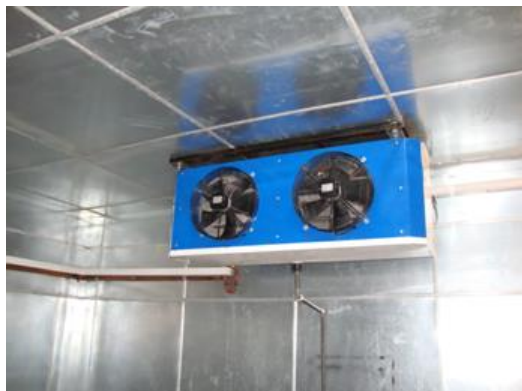
شکل ۳۱: تاسیسات داخل سردخانه
