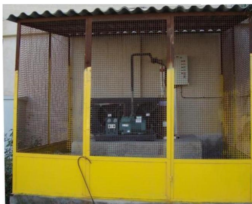
شکل ۳۰: تاسیسات خارج سردخانه
