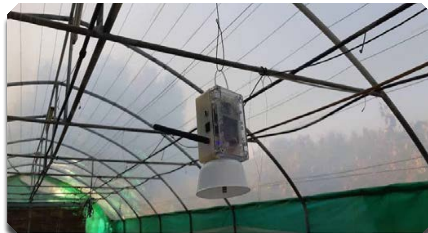
سامانه هشداردهنده نصب شده در گلخانه
