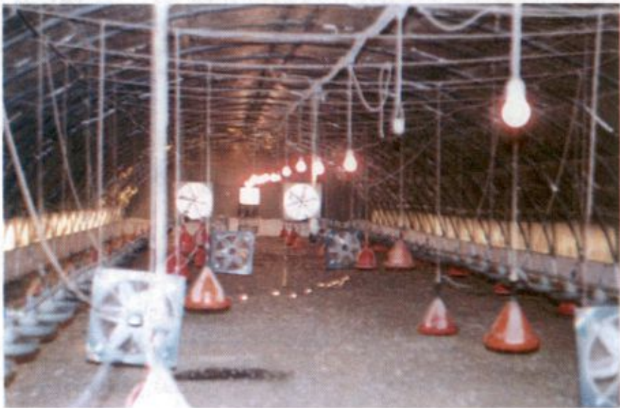
شکل ۱۰۰ : چگونگی نصب لامپ‌ها در سالن
