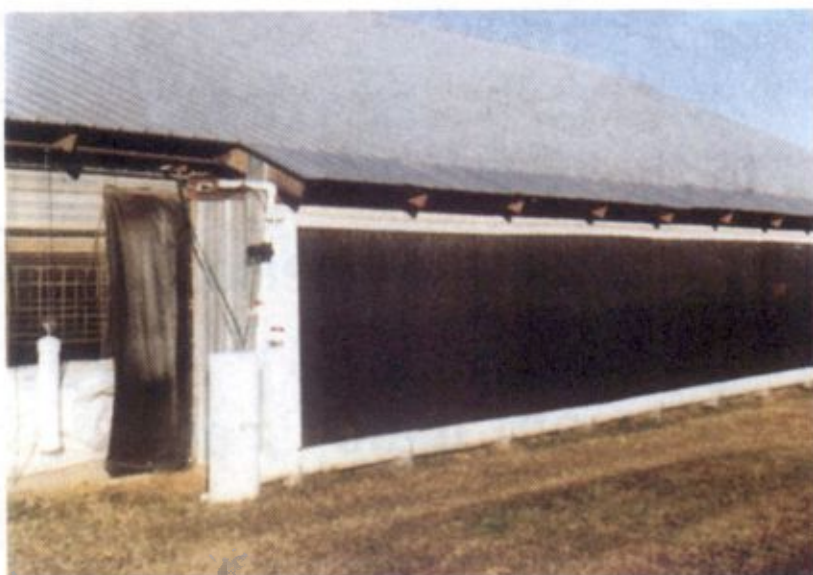
شکل ۹۷ : سیستم خنک کننده پوشال خیس که به جای پوشال از صفحه‌های سلولزی استفاده شده است
